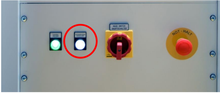
Abbildung 13: Taster zur Quittierung der Sicherheitsüberwachung am Schaltschrank
