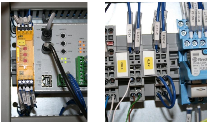
Abbildung 12: Sicherheitsschaltgerät und Klemmen für Sicherheitseinrichtung im Schaltschrank
